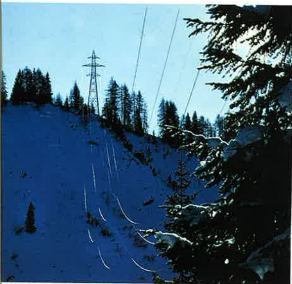
50/10 kV-Talleitung in der "Blau Rüfi" vor Arosa
